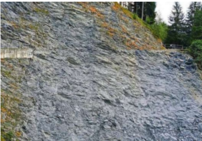
Plötzlich bricht das Strassentrassee ab: So präsentiert sich die Felswand mit der gesperrten Via Varduz seit rund einer Woche. Bild: Claudio Gernreich
